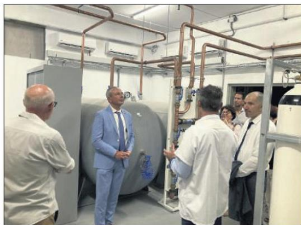
L'air comprimé et épuré est fabriqué et stocké dans ce local technique.
